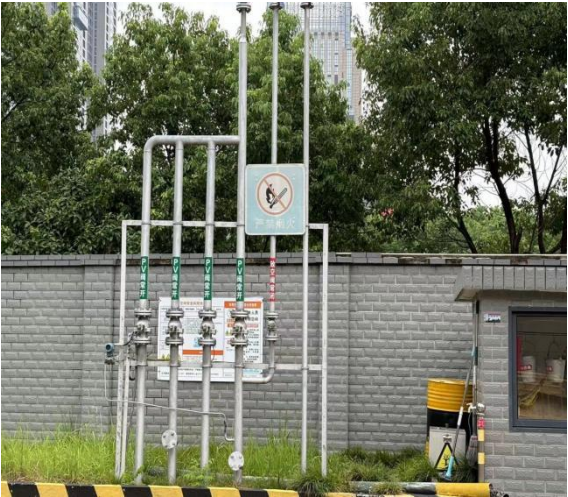
油气回收系统排放设施
