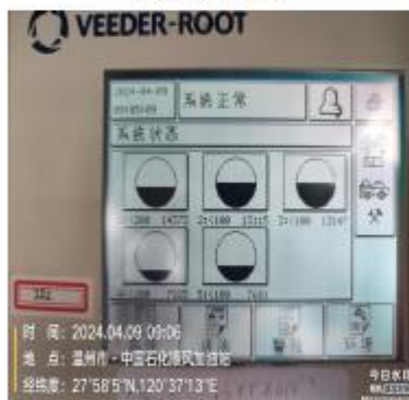
现场液位仪照片
