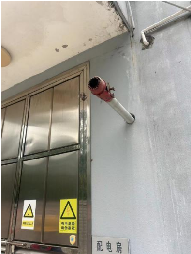
柴油机废气排放口
