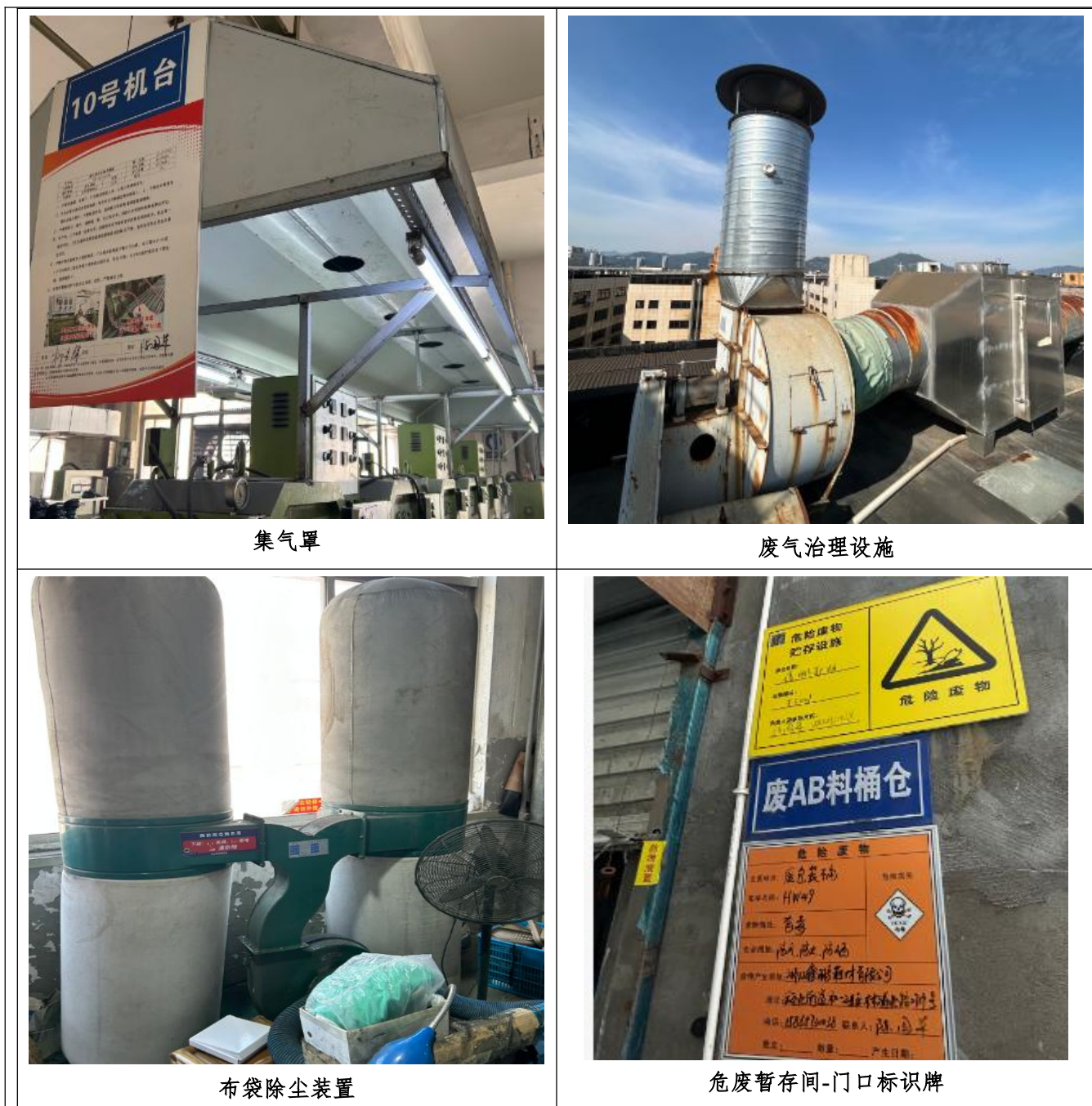
图3-1环保处理设施图片
