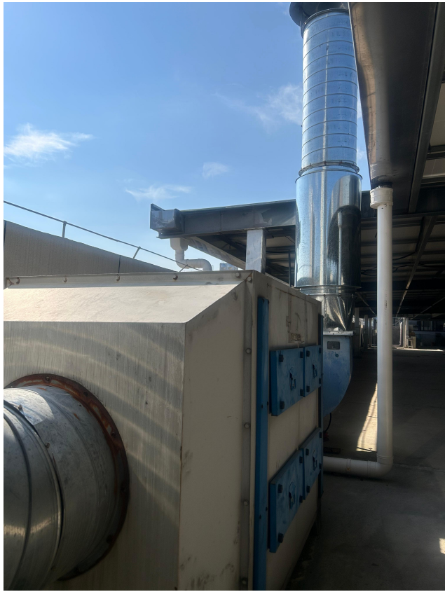
安全鞋注塑废气治理设施（活性炭）排放口 DA002
