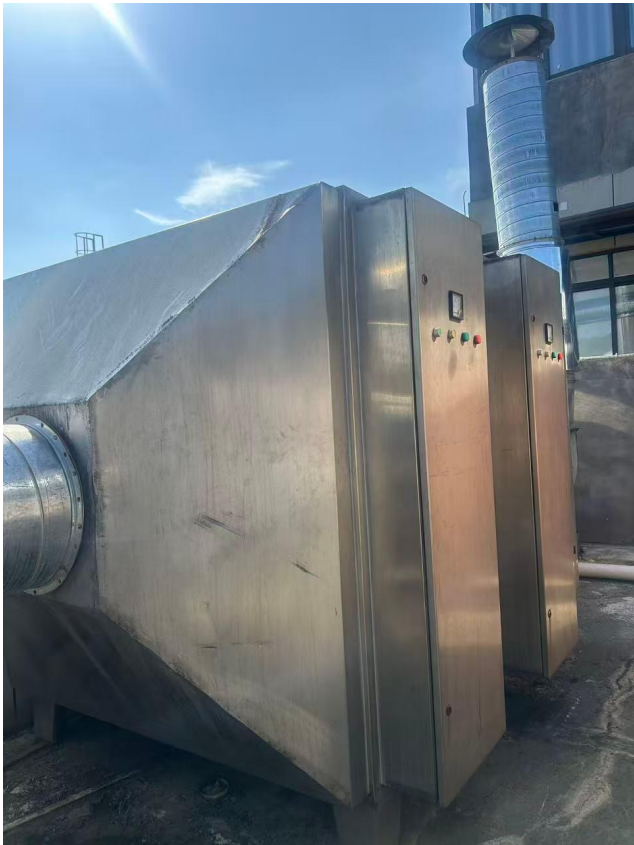
综合废气治理设施（活性炭）排放口 DA001
