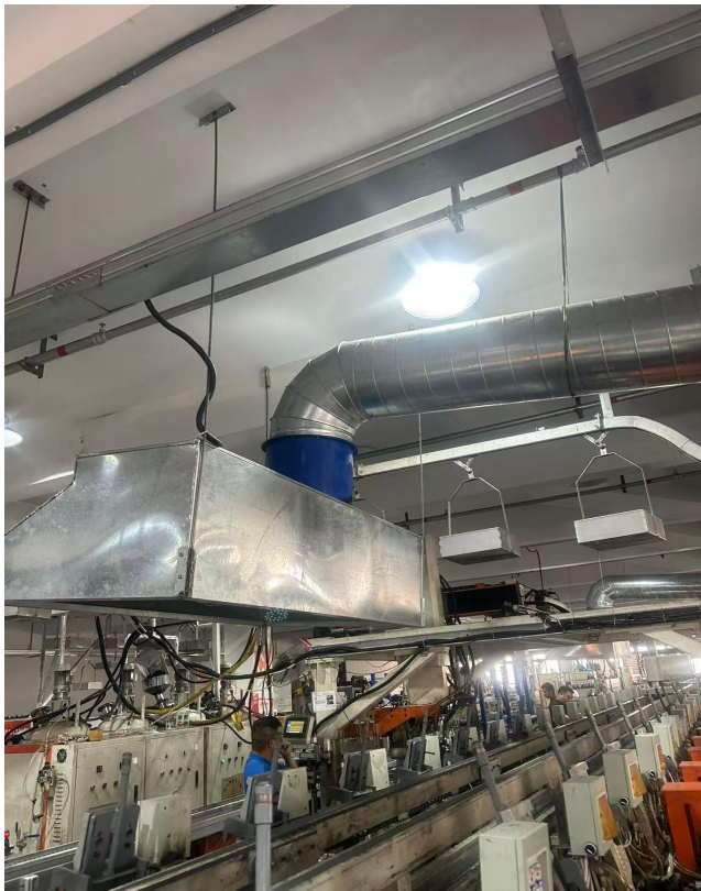
安全鞋注塑废气收集设施
