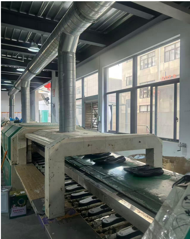
冷粘线废气收集设施
